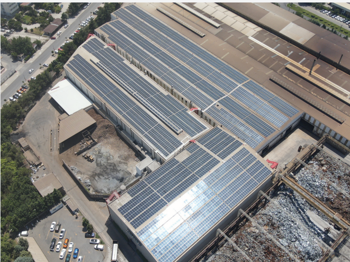
Çemtaş Çelik Çatı GES, 1.9 MW, Bursa
