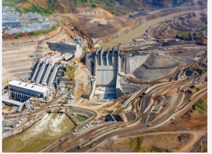
Kalehan Enerji, Aşağı Kaleköy HES, 450 MW, Bingöl
