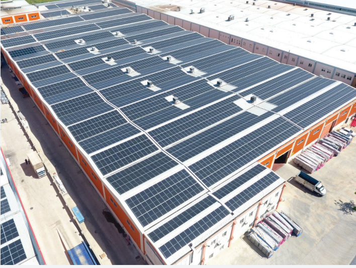
Angel Carpet Çatı GES, 2.6 MW, Gaziantep
