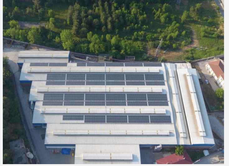
Yücel Boru Çatı GES, 0.6 MW, Kocaeli
