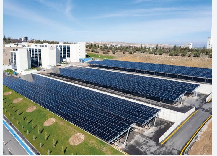
Başkent Üniversitesi Çatı-Carport GES, 2.1 MW, Ankara
